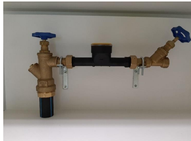
Etäluettava vesimittaripaketti telineessä
