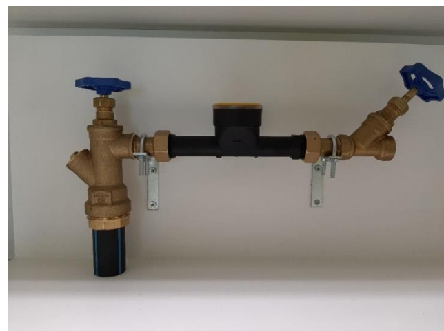
Etäluettava vesimittaripaketti telineessä
